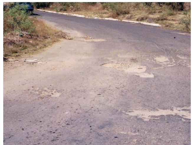
Fig. 2.25 Exemple de formation de nids de poule sur une chaussée rigide, par disparition localisée de la couche superficielle de roulement.
