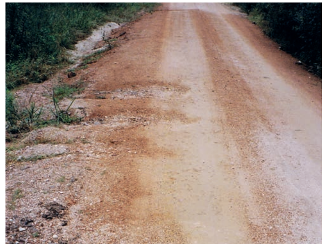
Fig.2.24 Plusieurs nids de poule de différentes profondeurs sur une chaussée non revêtue.
