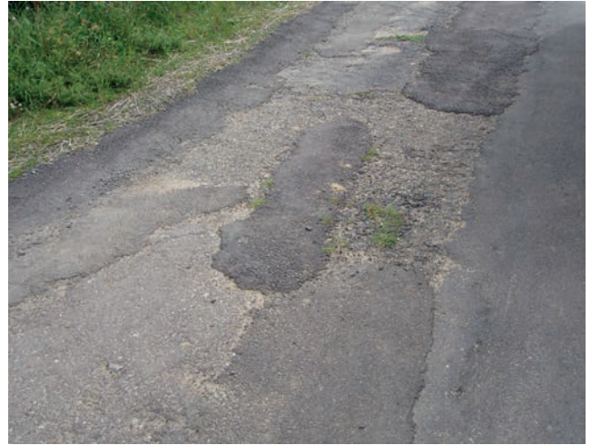
Fig. 2.27 Chaussée rigide dégradée avec ornière longitudinale. Les réparations successives créent des différences de surface qui sont autant d'obstacles verticaux.
