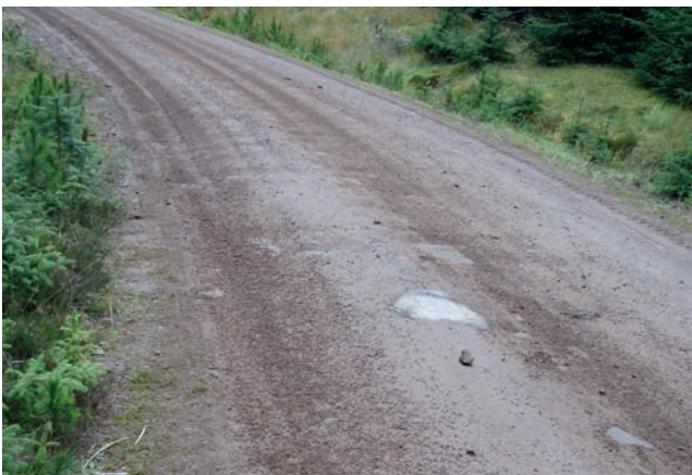
Fig. 2.29 Zone de tôle ondulée dans une courbe sur une chaussée non revêtue. Cela forme des barres transversales régulièrement espacées.
